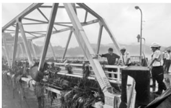
落橋した西瀬橋（人吉市） を視察する足立議員
