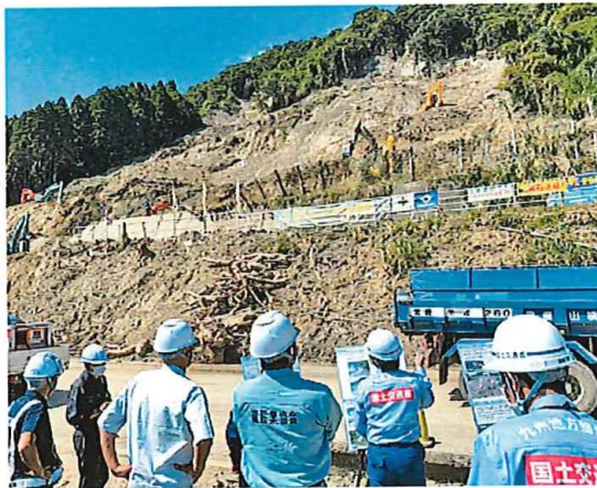
地滑り被害の復旧現場（6日撮影、足立敏之事務所提供）
