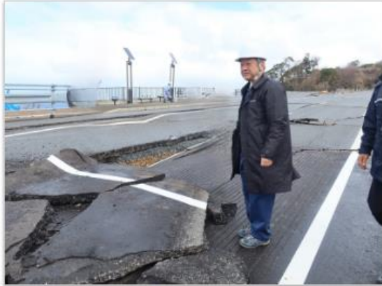
珠洲市内での道路被災を調査
